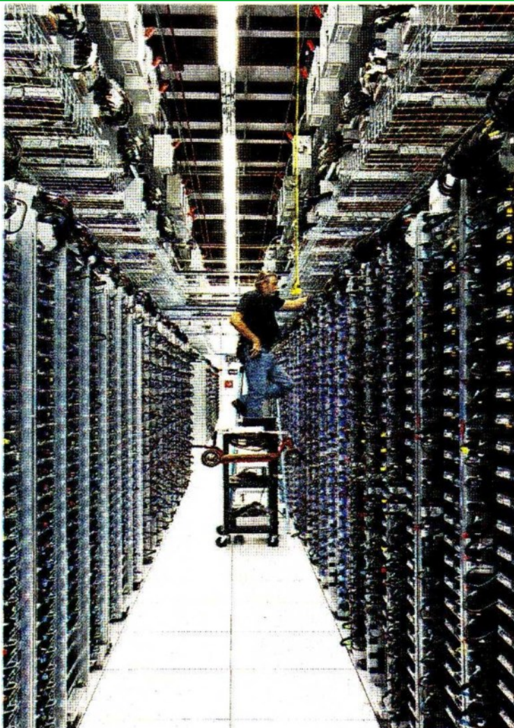
Manutenzione ai server di Google a Pryor, Oklahoma (foto EPA)
