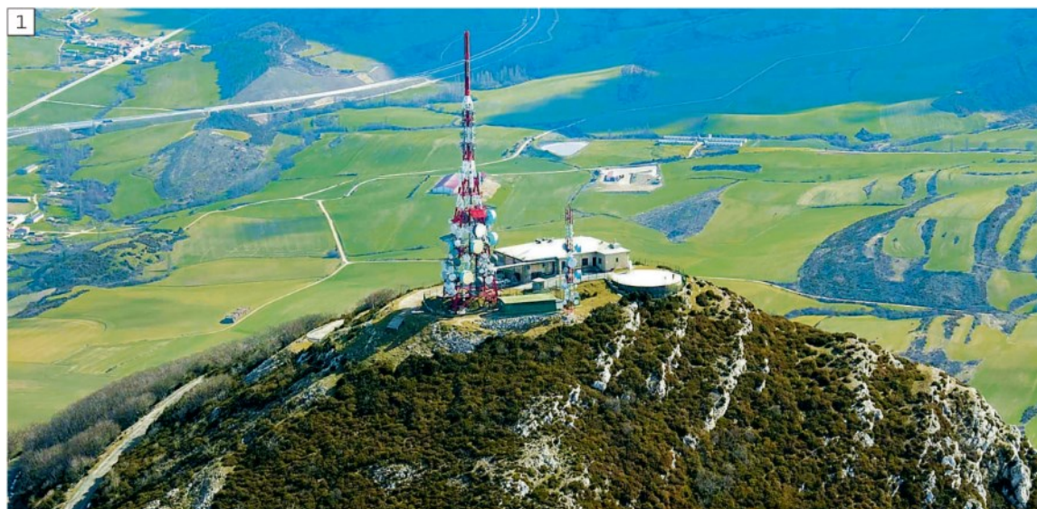
Una torre per le telecomunicazioni di Cellnex a Monreal, nei pressi di Pamplona, in Navarra
