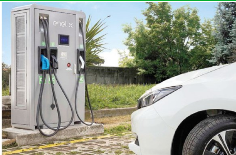
EnelX. Una centralina per la ricarica dell'auto elettrica
