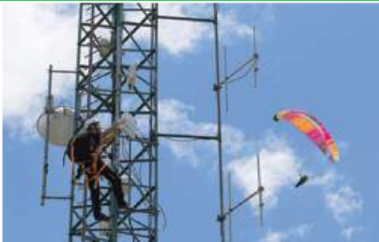
L'installazione di un trasmettitore internet su un traliccio
