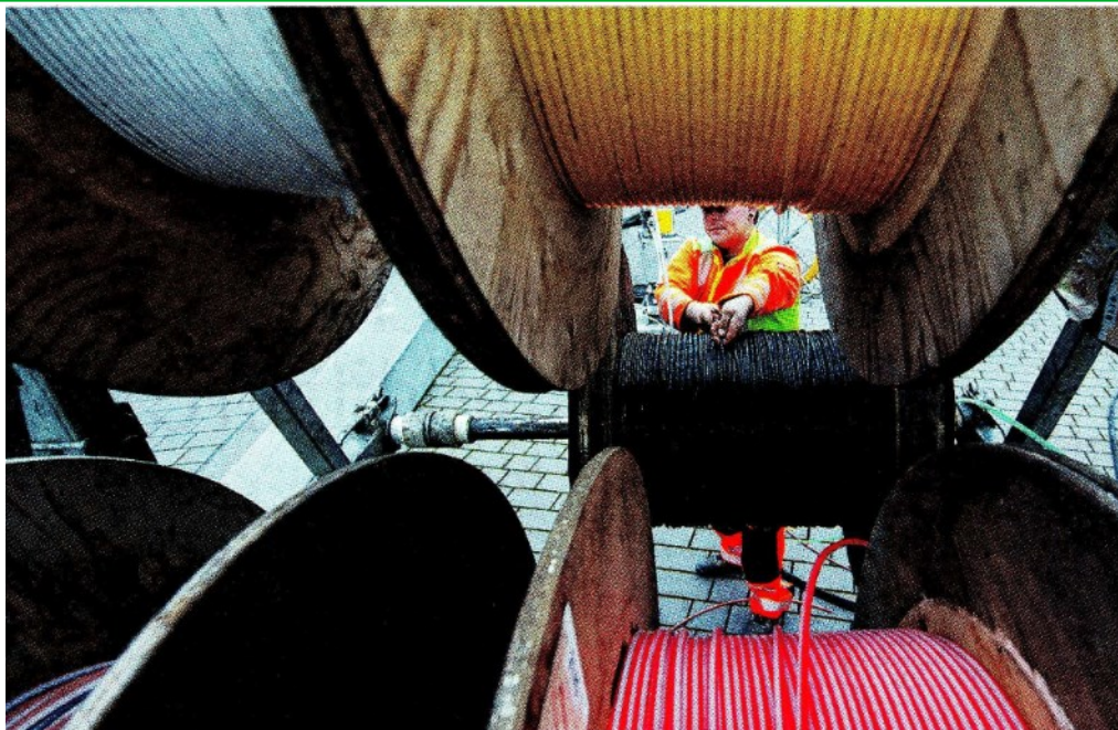
Sopra, cavi di fibra ottica pronti per la posa a terra. A destra una centrale telefonica
